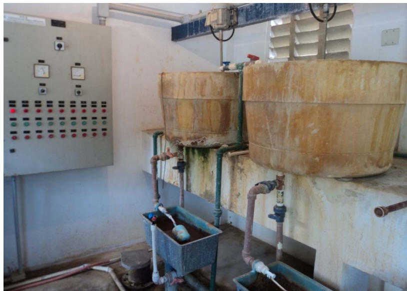
Figura 3.2.2 – Estação de tratamento de água CEDAE – Trajano de Moraes – Vista interna.
